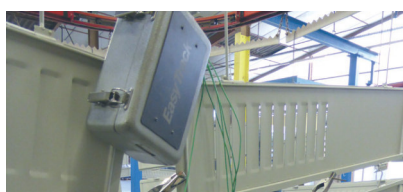
CONTRÔLE TEMPÉRATURE FOUR
